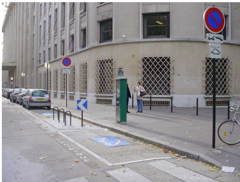
Point de charge sur la voirie
