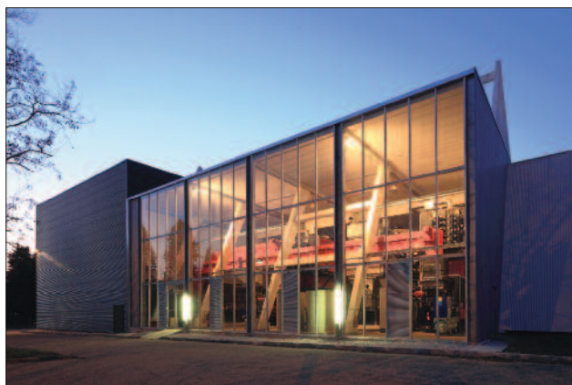
Chaufferie bois à Montpellier.
