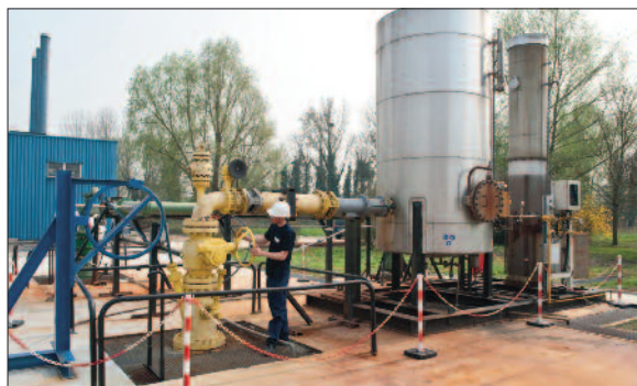
Puits de géothermie de Chelles. Photo Coriance / Cédric Helsly.
