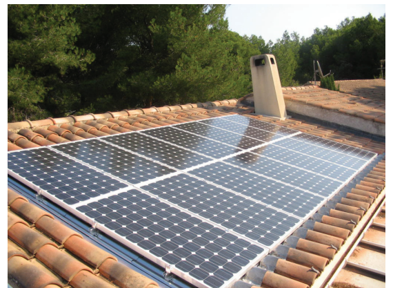
Panneaux solaires encastrés dans une toiture.
