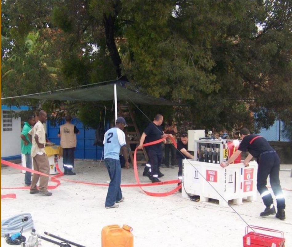
Station de potabilisation mobile mise en œuvre dans le cadre du pont humanitaire eau pour Haïti
